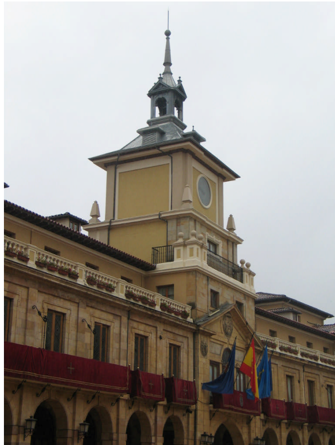
Rehabilitación de cubierta y elementos decorativos de la Torre del Reloj del edificio Casa Consistorial
