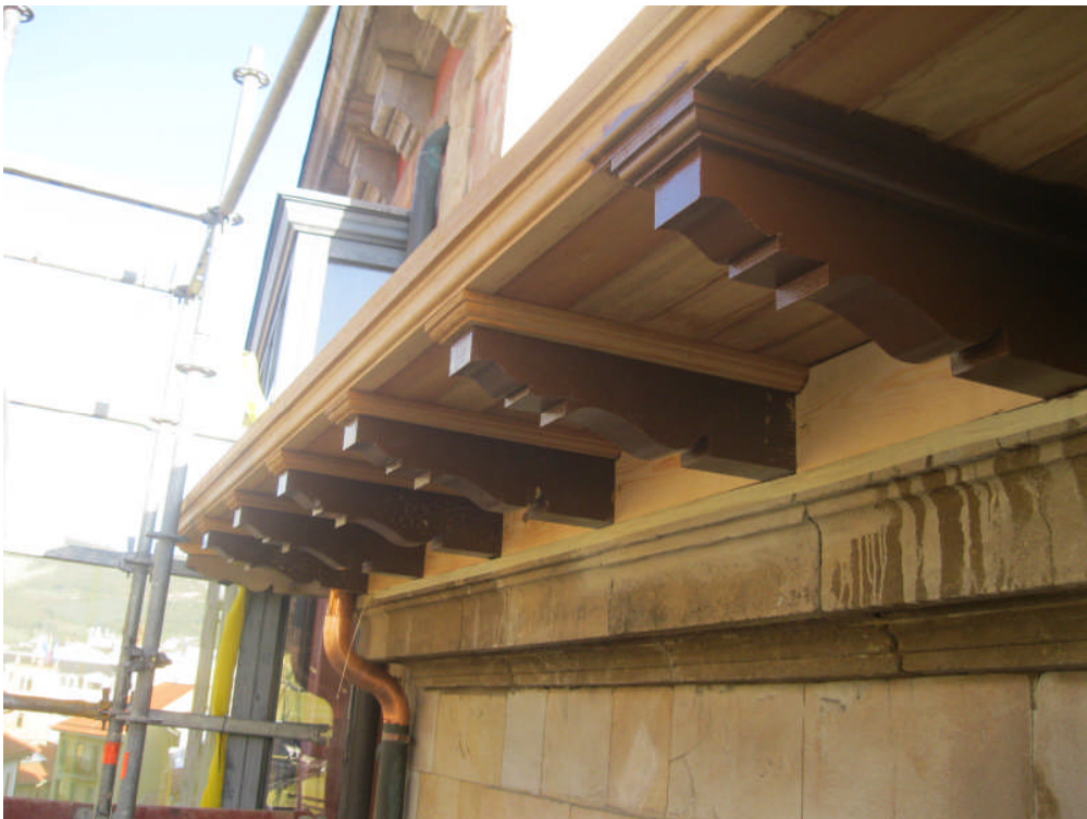
1ª Fase obra de sustitución de canalones y aleros del edificio Casa Consistorial.
